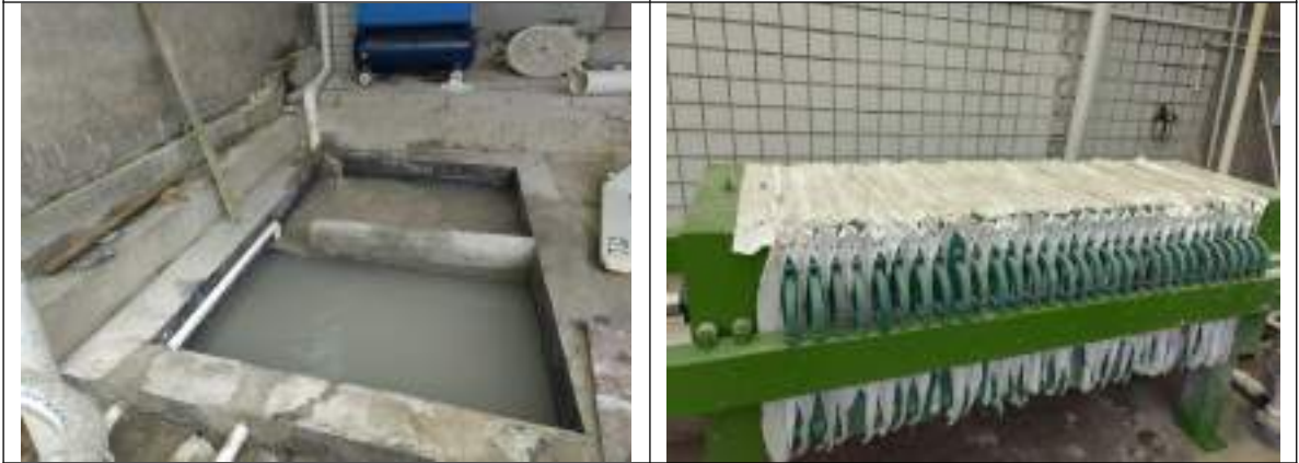
制釉废水预处理设施
