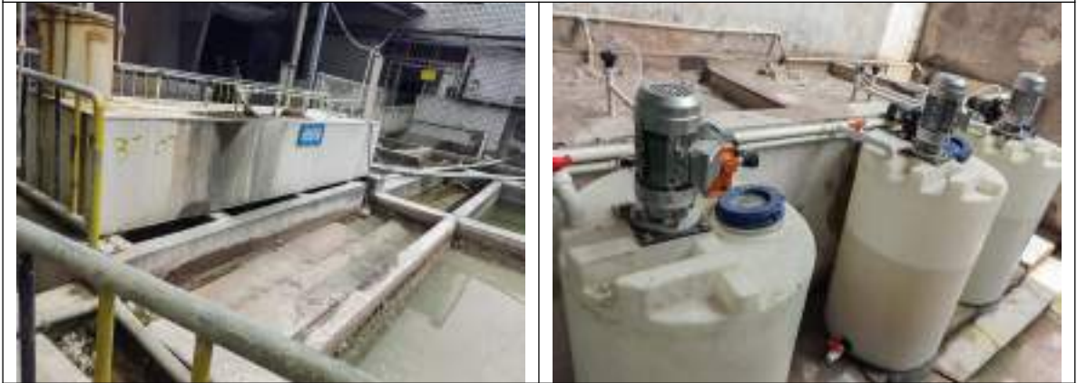
厂区综合污水处理站-自动加药装置
