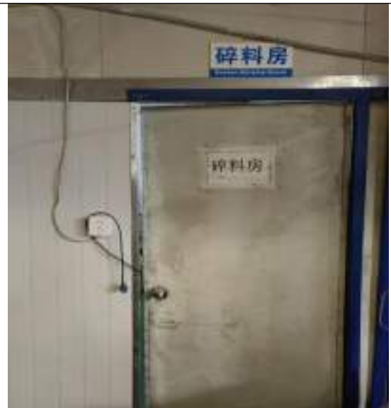
破碎机设置在密闭车间内
